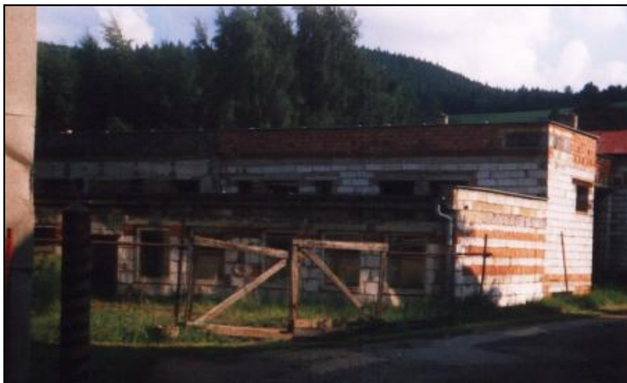
Přestavěný a přistavěný ale nedokončený objekt Hedva, který měl sloužit jako prozatímní balneoprovoz. (Foto současného stavu).
